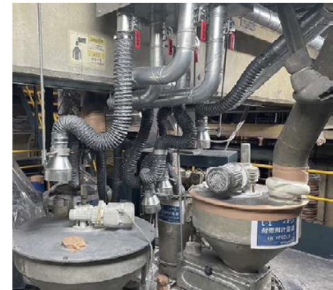
粉塵作業增設局部排氣設施
